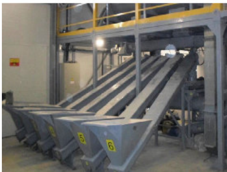
Рис. 2. – Общий вид контейнеров с установленным технологическим оборудованием
