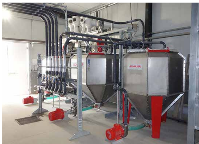
Рис. 2. Общий вид смесительной установки комплекта оборудования для жидкого кормления Liquimix фирмы Schauer
